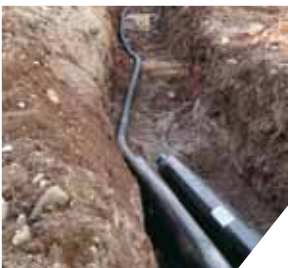
Réutilisation en tant que filler pour les conduites de chauffage à distance
