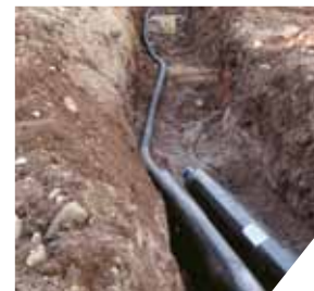
Réutilisation en tant que filler pour les conduites de chauffage à distance
